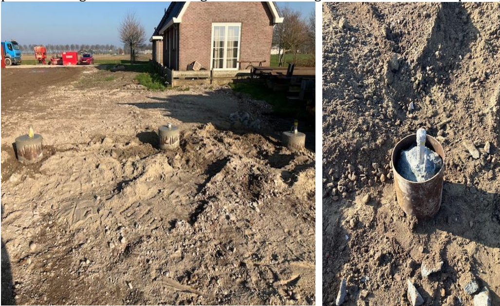
FIGUUR 13 OVERZICHT VAN DE PROEFPALEN IN OOSTWOUD VOOR EN NA HET AFSORTEN VAN DE CASINGS
